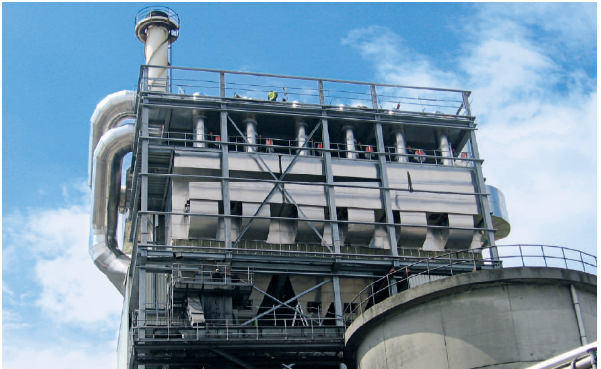
Purificación de gases de combustión de carbón con incineración de materia residual, incluyendo el suministro de aditivos y la evacuación del polvo suspendido. Cantidad de aire total: 165.000 m 3 /h con una temperatura operacional de 160 °C.
