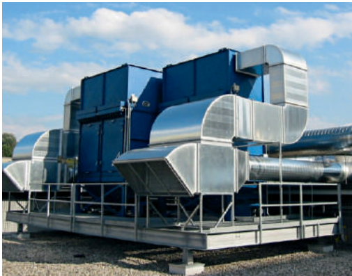
Sistema de colección de polvo en una planta de revestimiento térmico con recuperación de calor, caudal volumétrico 2x 15.000 Bm 3 /h.
