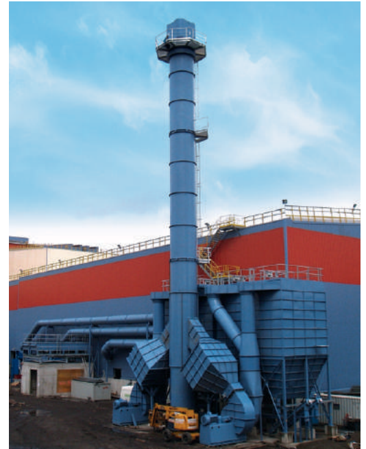
Planta de desbaste en caliente en Bélgica, caudal volumétrico 300.000 Bm 3 /h.
