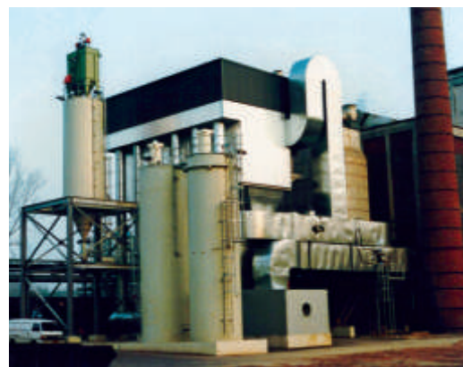
Rauchgasentstaubung, Papierfabrik Zülpich.
