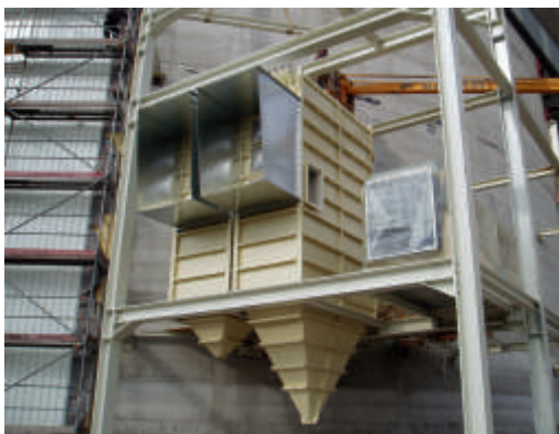
Klimatisierung eines 50.000 t-Zuckersilos mit Entstaubungsanlage für die Transportwege in der Montagephase.
