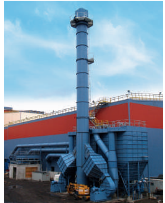
Heißbrammenschleifanlage in Belgien, Volumenstrom 300.000 Bm 3 /h.
