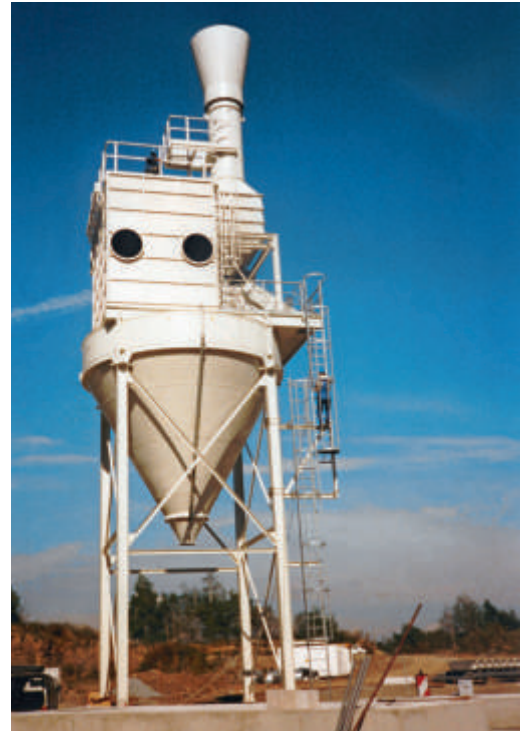
Absaugung Brecheranlage in einem Kalksteinwerk.
