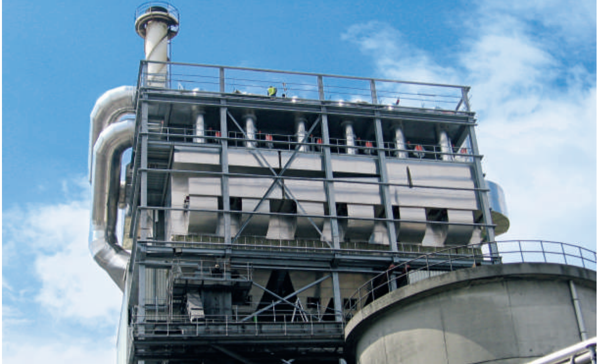
Rauchgasreinigung von einer Kohlefeuerung mit Reststoffverbrennung inklusive der Additiv Aufgabe und Flugstaubentsorgung. Luftmenge insgesamt: 165.000 m 3 /h bei 160 °C Betriebstemperatur.
