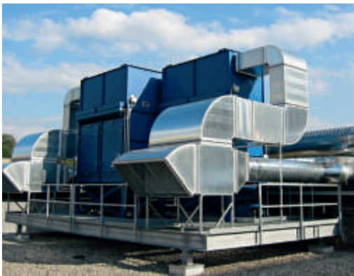
Entstaubungsanlage einer thermischen Beschichtungsanlage mit Wärmerückgewinnung, Volumenstrom 2 \times 15.000 \text{ Bm}^3/\text{h} .
