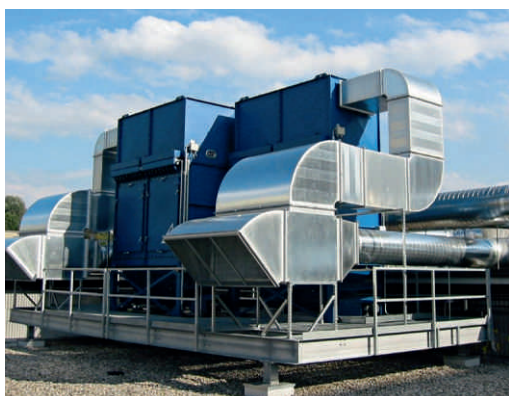
Пылеочистка установки термического нанесения покрытия с тепловой рекуперацией, объемный расход 2X 15 000 м³/ч.
